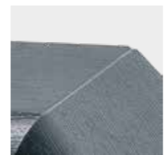
soldadura V-Perfect por defecto
